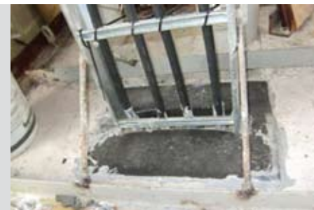
4) 반대편을 다시 CFS-S SIL LD 패드를 이용하여, 재단하여 넣어 개구부를 막은 후, 다시 패드와 패드 사이, 패드와 케이블 사이, 패드와 콘크리트 사이를 방화실란트를 이용하여 코킹합니다.
